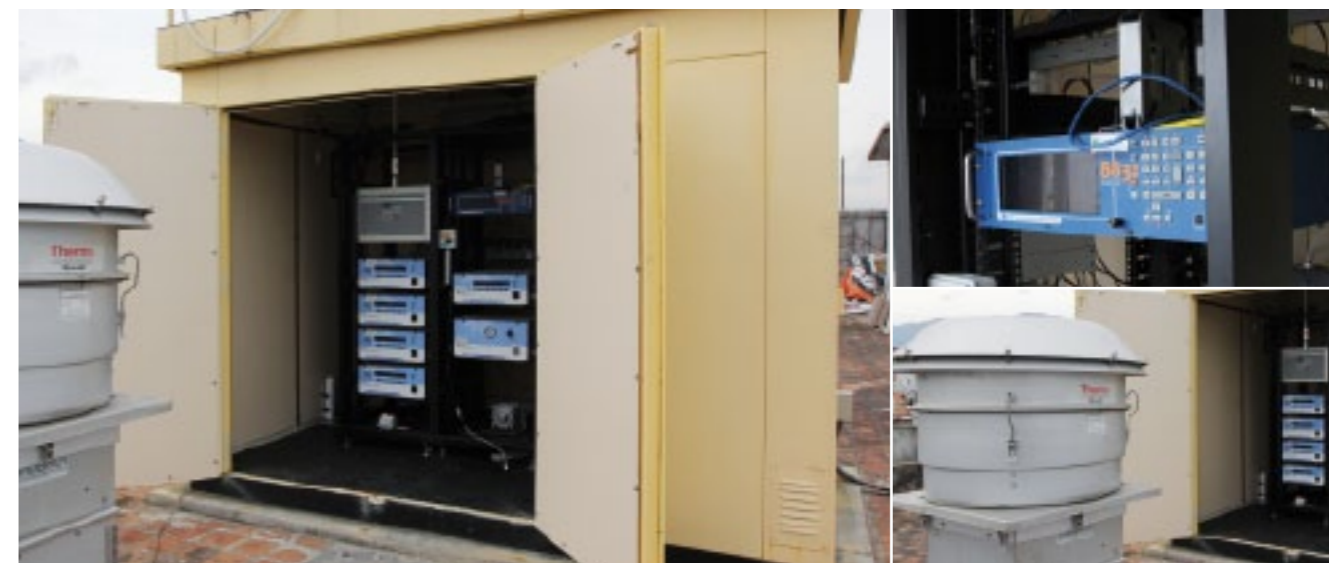
Figura 4: Estación automática de calidad del aire y meteorología localizada en la estación del Municipio (MUN)
