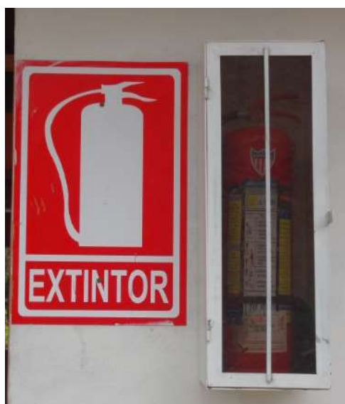
Cuentan con extintores en el área de trabajo
