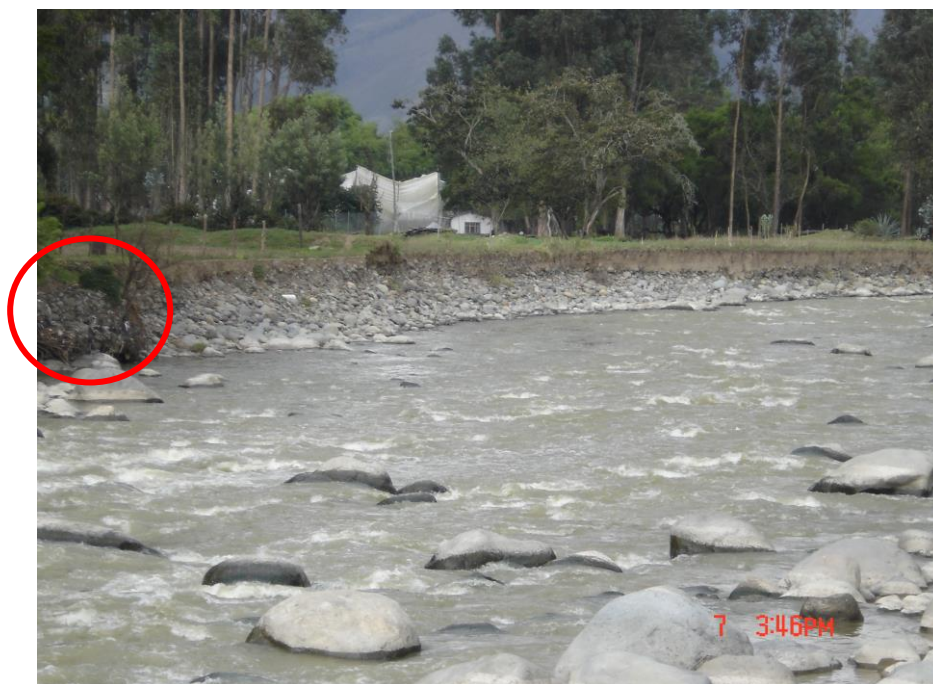
Margen izquierda de la zona 5, muros de gaviones colapsados y la socavación de la orilla
